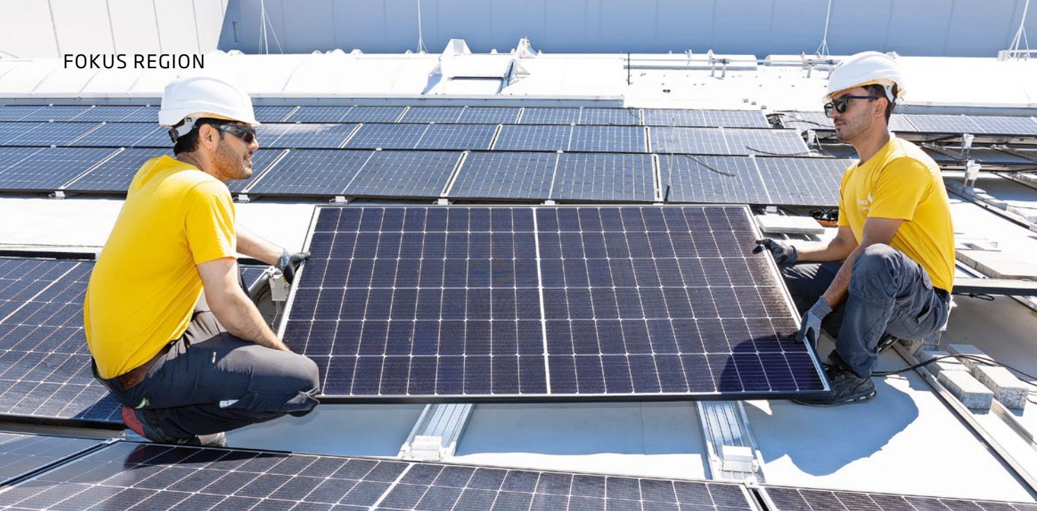
Die Installation von Photovoltaik macht die Hälfte des Umsatzes aus. Die andere Hälfte entfällt auf Wärme- und Kältetechnik, Batteriespeicher und Elektromobilität. FOTO: RALF LUTTER
